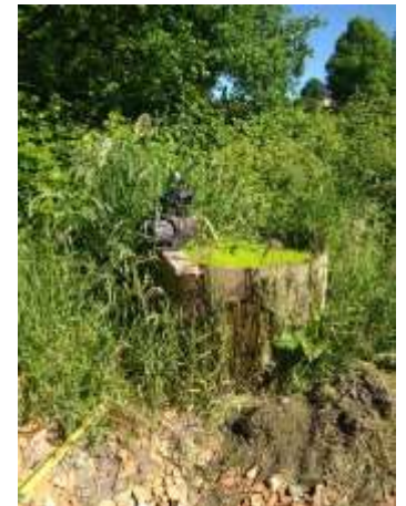
Figure 22: Source busée pour un pompage sur le Brisebois
